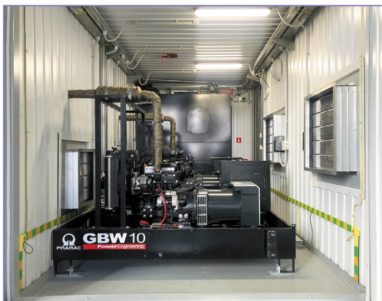
Рис. 1. Автономная электростанция АСЭР-16 производства компании «Лиотех» с системой накопления энергии
